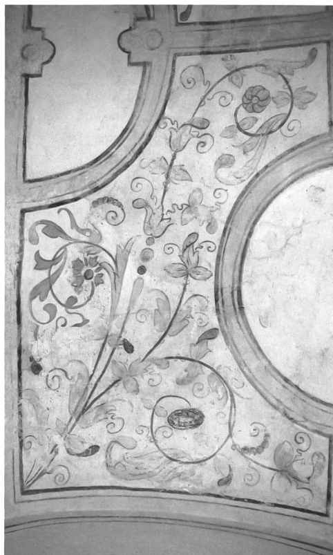
Fig. 113 Voûte de la chapelle du cloître, côté nord; portion du décor de 1595, avant intervention.
