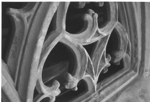
Fig. 93 Remplage (travée 16) avant intervention. La partie sculptée extérieure se détache par plaques correspondant au litage vertical de la pierre. Ces éléments menacent de se détacher complètement. Fig. 94 Même vue après traitement. Les détachements ont été consolidés, tout d'abord par application d'un ester de silice pour renforcer la cohérence de la pierre, puis par application d'un mortier de poudre de molasse mêlée à un liant minéral.
