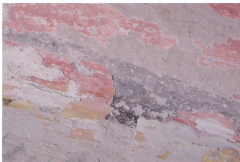
Fig. 79 Voûtain de la travée 23; phase I (1320-1330): épais filet noir en bordure de voûtain; phase II (XVI e siècle): fragments de bordures jaune et rouge; phases III et IV: traces de badigeons monochromes ultérieurs.
