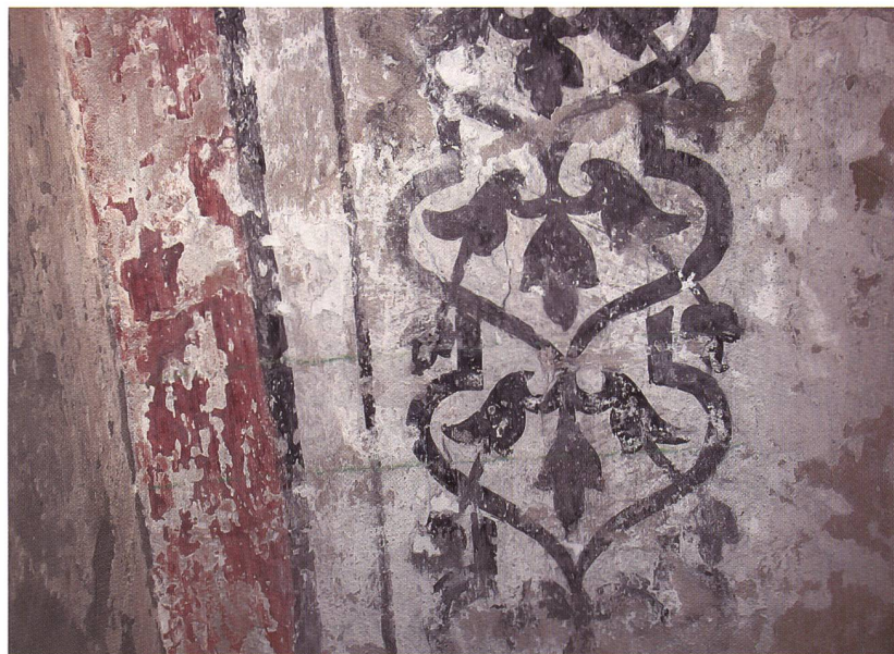
Fig. 83 Voûtain de la travée 19; détail d'une bordure et motifs végétaux de la fin du XVI e siècle, largement surpeint lors de la restauration de 1910-1913, avant intervention. Abb. 83 Gewölbe in der Travee 19; Bordüre mit Mauresken vom Ende des 16. Jh., anlässlich der Restaurierung von 1910/13 weitgehend übermalt, angetroffener Zustand.
