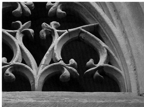
Fig. 14 Remplage présentant des cassures. Abb. 14 Masswerk mit Bruchschäden.
