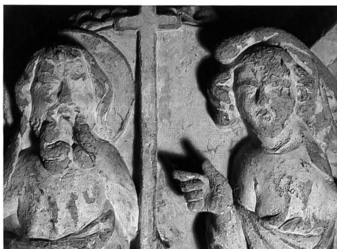
Fig. 21 et 22 Clef de voûte de la travée 15; état vers 1930 et en 2002: la comparaison montre les progrès de la dégradation.
