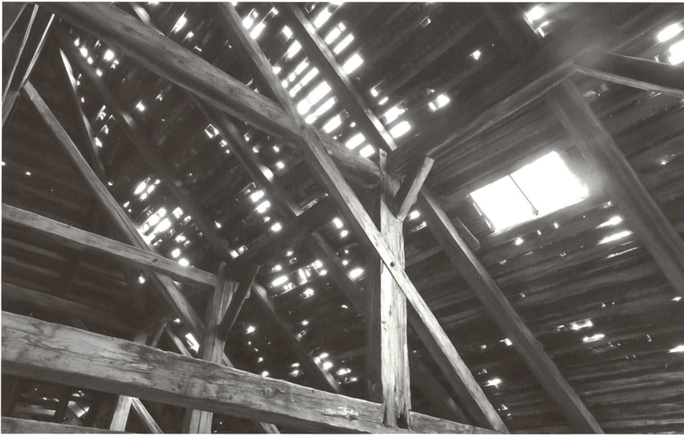
Fig. 13 Détail de la charpente et état de la couverture actuellement bâchée, suite à l'orage de grêle du 23 juillet 2009.
