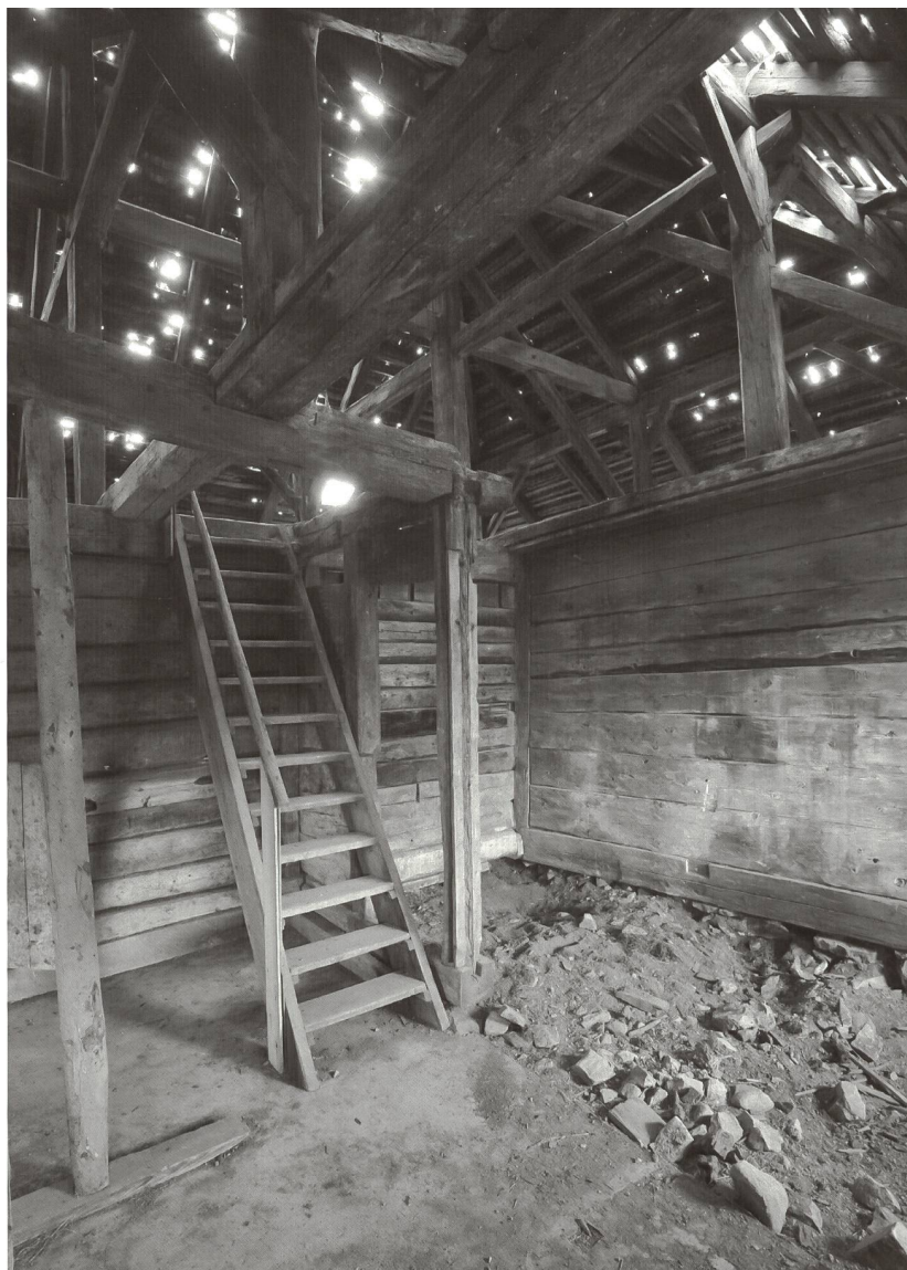
Fig. 4 La montée au «chôlé», le soliveau où dormaient les armaillis. La paroi divisant la chambre à lait n'était déjà plus en place lors de l'analyse de la construction. Elle a sans doute permis d'aménager postérieurement une petite chambre au rez-de-chaussée. La paroi en madriers du «gournê», le grenier ou saloir, repose sur un soubassement en maçonnerie, possible vestige de la construction de 1690.
