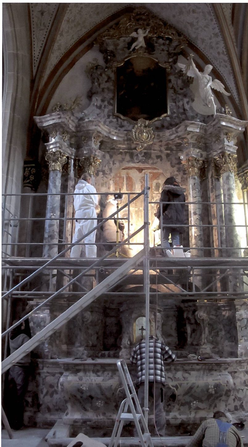
Fig. 6 Les restaurateurs au travail, devant l'autel de la Nativité, dans la 1 re travée du collatéral nord.
