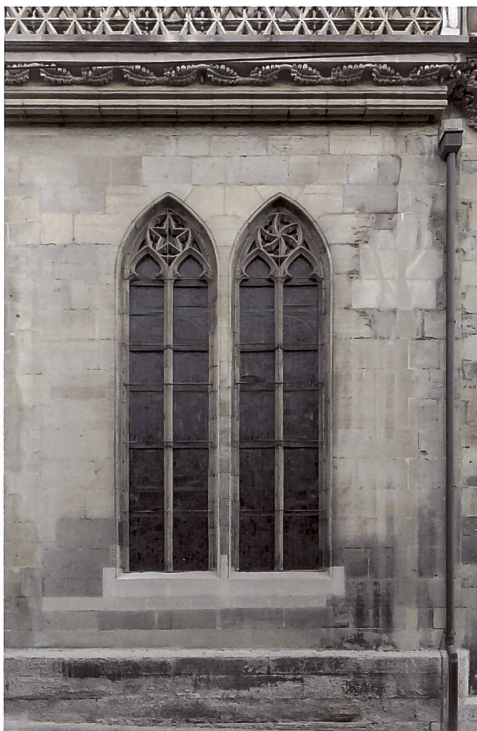
Abb. 68 Südfassade, Ölbergkapelle, vor der Restaurierung. Die Fenster wurden im 19. Jahrhundert nach unten und vermutlich nach oben verlängert und mit neuem Mittelpfosten und Masswerk versehen. Rechts die grosse Sakristei von 1632. Gebälk, Brüstung und Konsolenfigur neugotisch.
