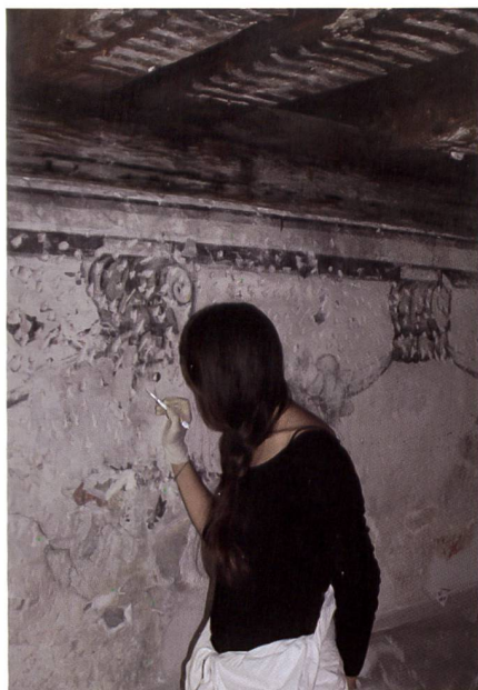
Fig. 160 Work in progress : retouches et consolidations de l'enduit et du décor de 1711-1712 après dégagement et avant compléments.
