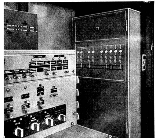
Fernsteuerungsanlage, Bahnhof Göschenen
