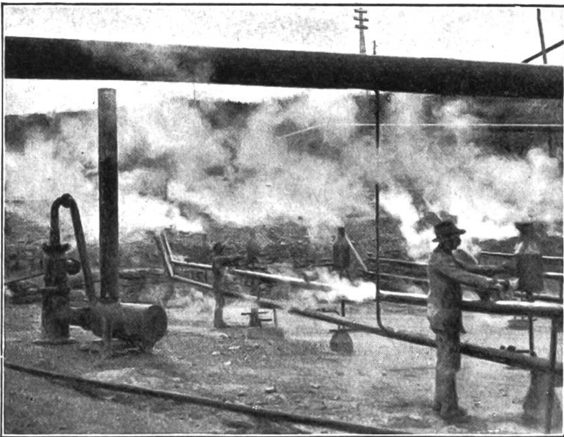
E i n e S t a t i o n , an der die mit Dampf gefüllten Rohre zusammenlaufen.
