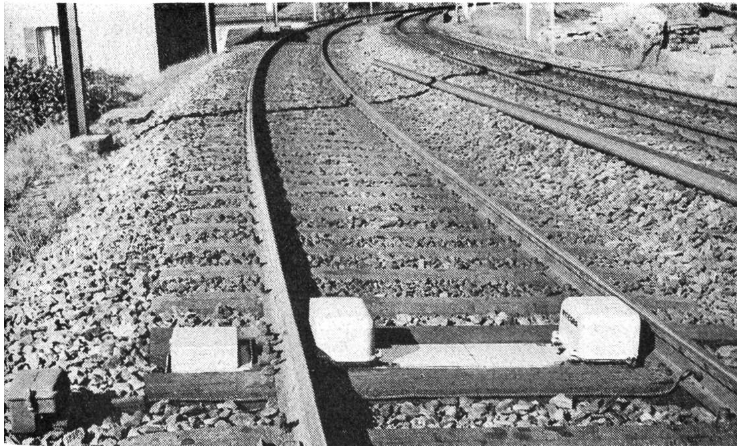
Achszählapparate zählen beim Einfahren eines Zuges in den Blockabschnitt die vorüberrollenden Wagenachsen und steuern automatisch die Blocksignale.
