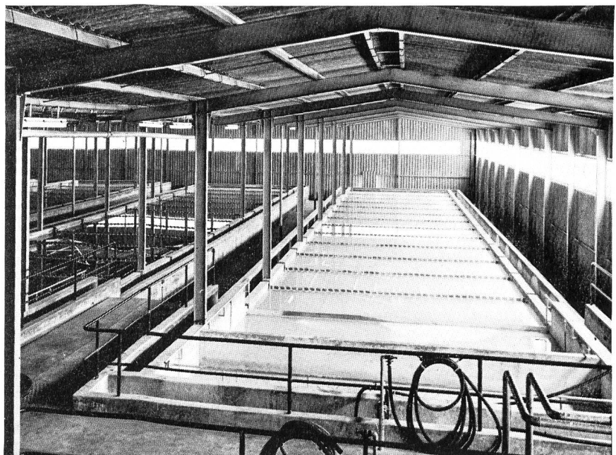
Mechanisch-biologische Kläranlage einer Papierfabrik
