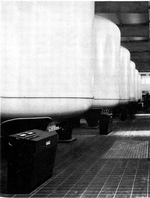
Werkfoto: Rheinwasser (uferfiltriert) für Trinkzwecke Geschlossene Bauart Zweischichtfilter mit nachgeschalteten Aktivkohlefiltern, vollautomatischer Betrieb
