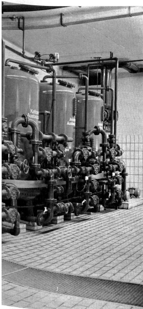
Abb. 1. Ein Blick in die Ionenaustauscher-Kreislaufanlage. Von links nach rechts kann man den Aktivkohle-Kiesfilter (angeschnitten), den Kationen- und den Anionenaustauscher der Strasse 1, den Kationen- sowie den Anionenaustauscher der Strasse 2 und schliesslich den Schlussreiniger erkennen. Ebenfalls ersichtlich sind die Sicherheitsventile für den automatischen Betrieb sowie die Strömungsmesser
