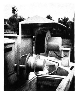
Federkabeltrommel als Längsstromzuführung an einem Längsräumer in einer Kläranlage, Kabelzug horizontal
