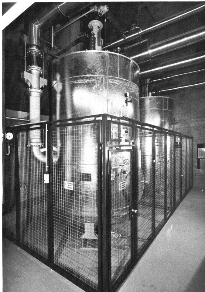
Zwei Sulzer-Elektrokessel von je 10 MW für die Wärmeversorgung eines Druckereizentrums in Stuttgart.
