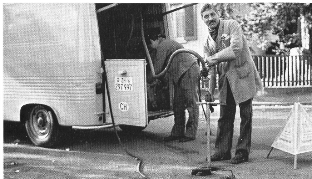
Regenerierung alter Gussleitungen nach dem Fliessverfahren, hier beim Einfüllen in eine Leitung.
