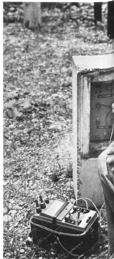
Messung des Kathodenschutz-Strompotentials an einer der Swissgas-Leitungen. Je Kilometer Hochdruckgasleitung...
