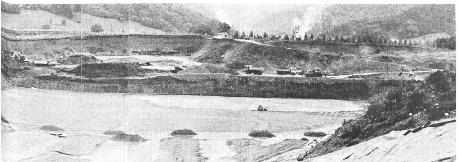
weisser Streifen) verlegt. Im Mittelgrund Sandhaufen und -lagen zur Beschwerung der verlegten Abdichtung. Anschliessend wird der Sand in der Stärke von 10 cm als Schutzschicht gegen Beschädigung (Durchstossen) ausgebreitet. Im Hintergrund noch Tiefbau-(Aushub-)Arbeiten (Bagger und Transportfahrzeuge). In Bildmitte hinten das Waaghaus = Standort der Aufnahmen der Abbildungen 1 und 9. Zeit der Aufnahme: Mitte August 1981.
