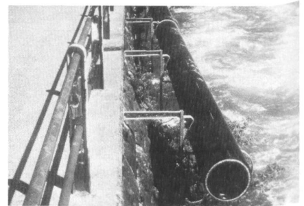
Isolierte Abwasserleitung aus Hart-Polyäthylen-Rohren.
