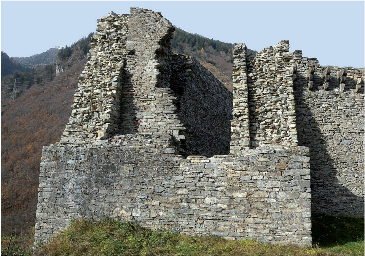
Ill. 20 - La torre sud eretta attorno al 1400 viene consolidata dopo il 1480 con costruzioni antemurali di uno spessore di 2 m, veduta verso nord-ovest (fotografia Servizio archeologico dei Grigioni)
