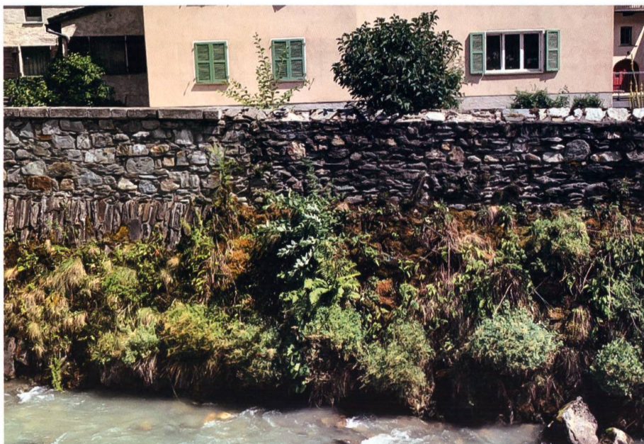
Ricoperta in parte dalla vegetazione, la muratura dell'argine presenta interventi di età diversa. Foto: F. Iseppi
