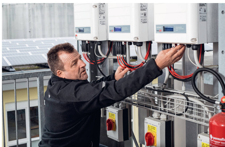
Der Betriebsstrom für Streule + Alder kommt vom eigenen Dach.
