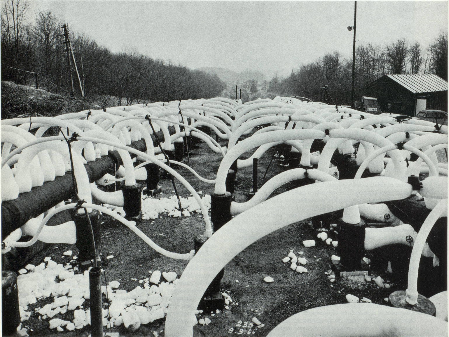
Congélation de la voûte du tunnel de Genevreuille — détail de la distribution du froid. (Photo Escher Wyss)
