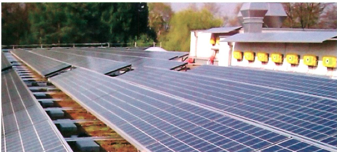
PV-Anlage Parkhaus Kurzentrum mit den Wechselrichtern (gelbe Boxen).
