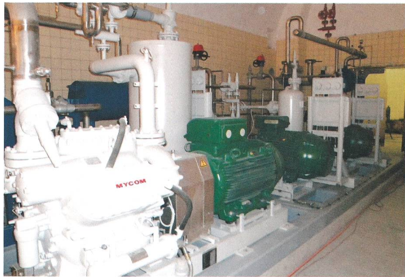
Die Wärmepumpen: 2 x 1 Megawatt
