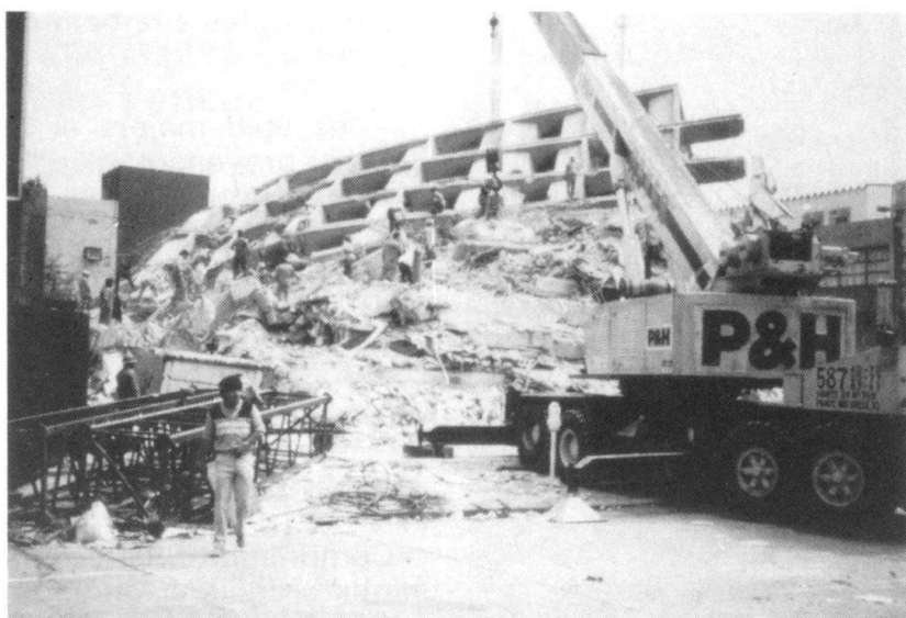
Après le tremblement de terre, opérations de sauvetage à Mexico-city (septembre 1985).
