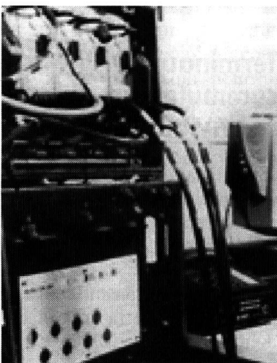
Commutateur nodal pour les équipements de commutation nodale: nombreuses liaisons pour faisceaux, peu de terminaux (abonnés).
