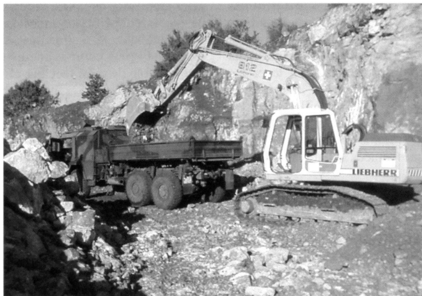
Au Kosovo, les travaux de reconstruction vont bon train grâce à l'engagement des moyens de la SWISSCOY. (Photo: AFO).
