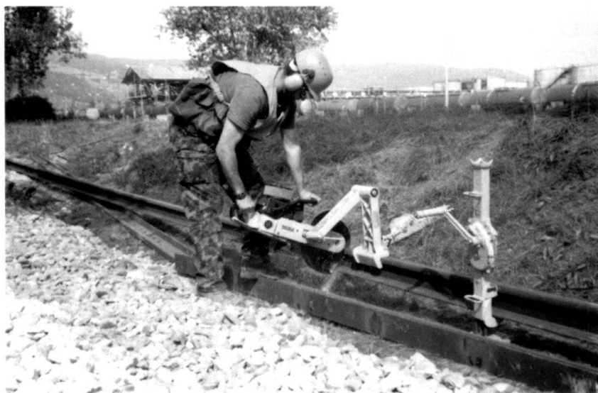
Travail à l'aide d'une poulie découpeuse à benzine selon les prescriptions de la CNA.
