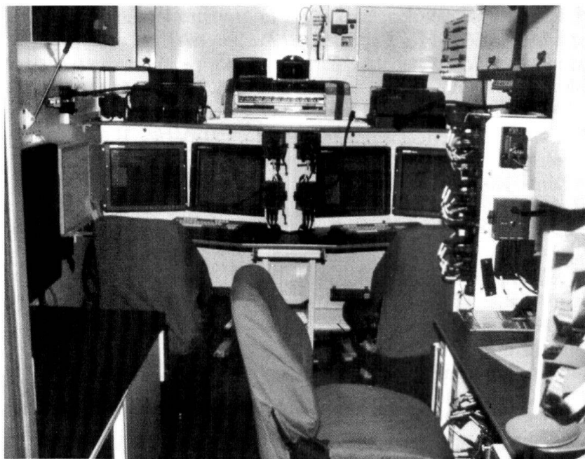
L'intérieur de Radio Access Point (RAP) de Thales Suisse.
