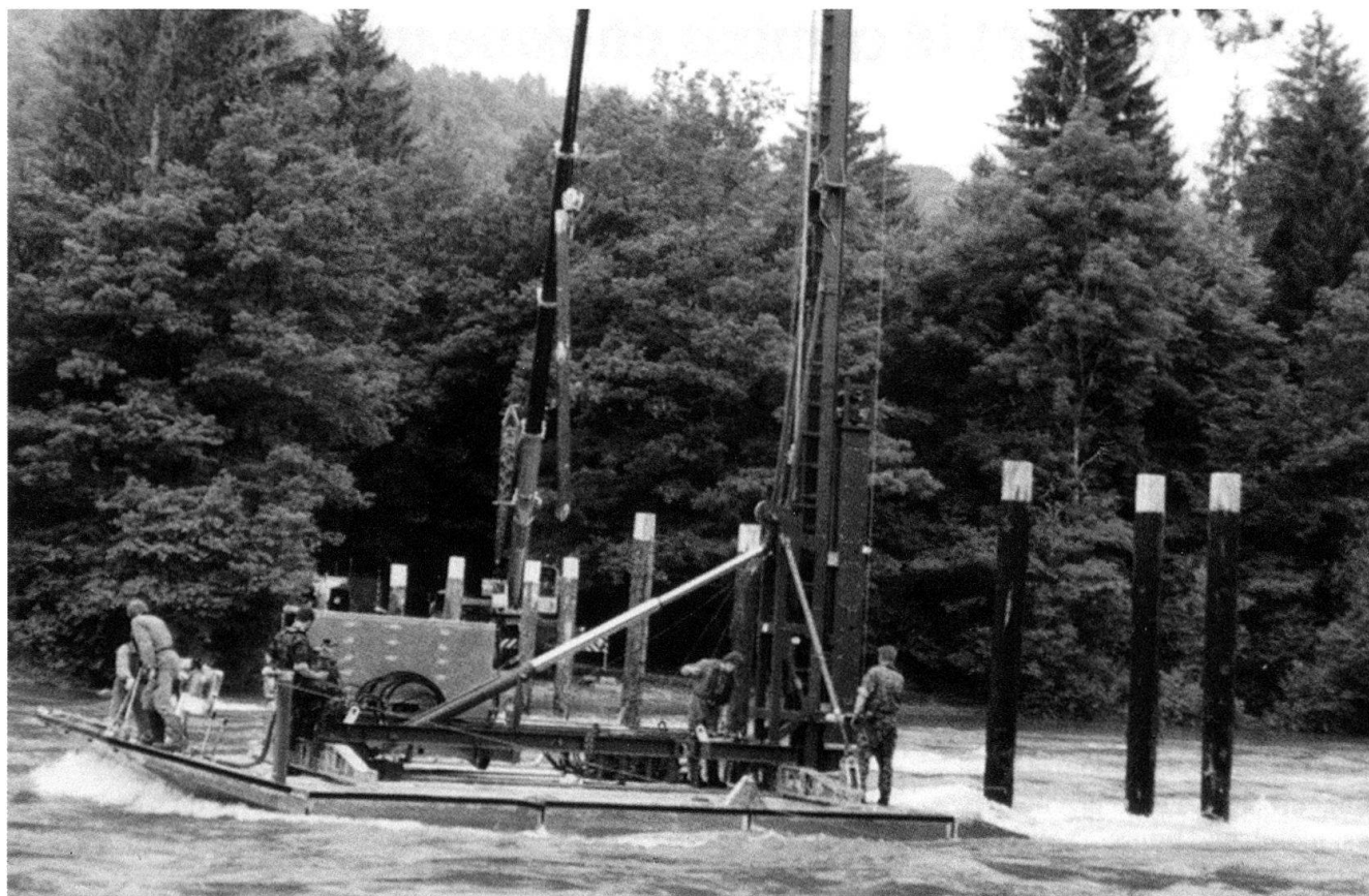
Les troupes du génie ne servent pas seulement à construire ou à détruire...
