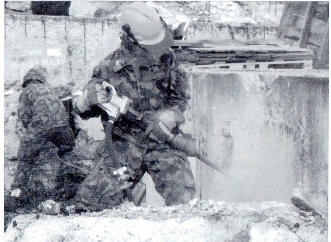
L'intervention dans le cas de sinistres nécessite souvent le déblaiement de gravats...
