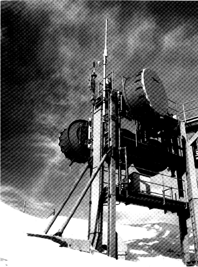
Antenne Link 16 et son mat de transmission par ondes dirigées.
