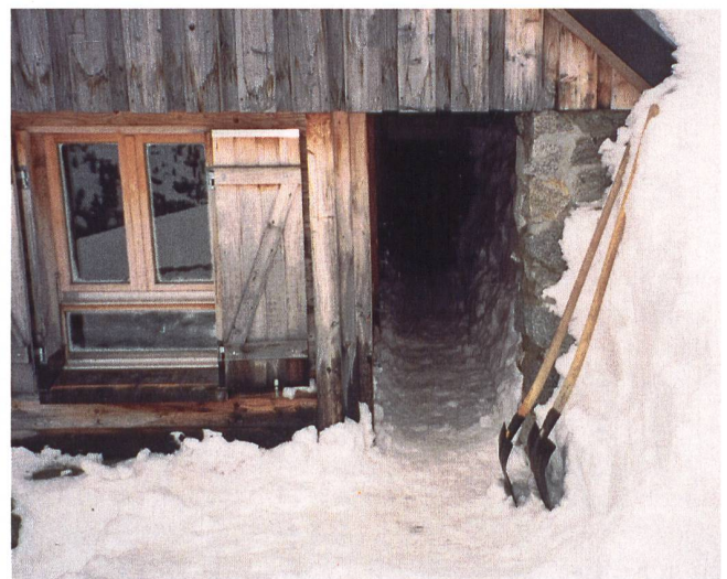
Als der Eingang noch nicht geschützt war, drang der Schnee bis weit in die Hütte ein und musste im Frühling hinausgeschaufelt werden.
