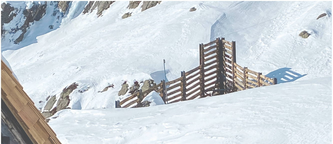
Die Lawinerverbauungen fügen sich gut in die Landschaft ein. Bild: Isabelle Kull, Geotest.
