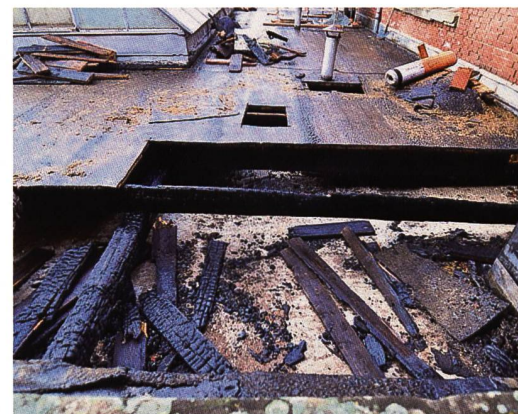
Verkohltes Gebälk im Zwischenboden des Werkhallendachs
