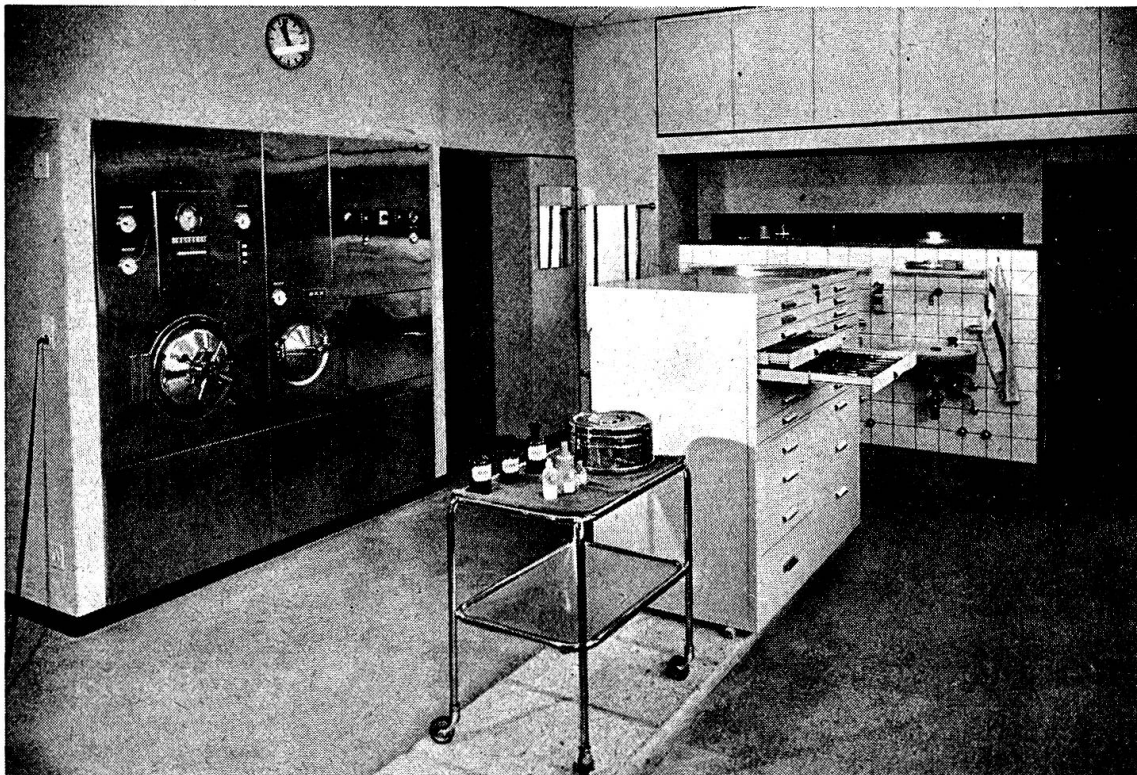
Abb. 5 Instrumenten- und Sterilisationsraum. Vollautomatischer Sterilisator links. In der Mitte Schnellsterilisator. Rechts Heißluftsterilisator und Wärmeschrank für Infusionslösungen. Norm-Werkzeugschränke zur Aufbewahrung der Instrumente.
