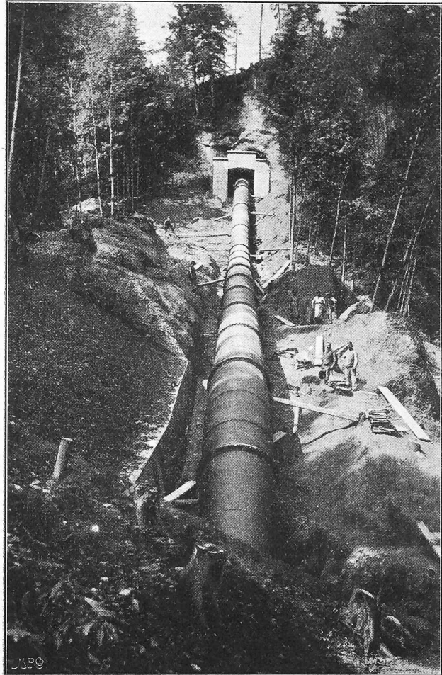
Abb. 30. Mittlerer Teil der Druckleitung.
