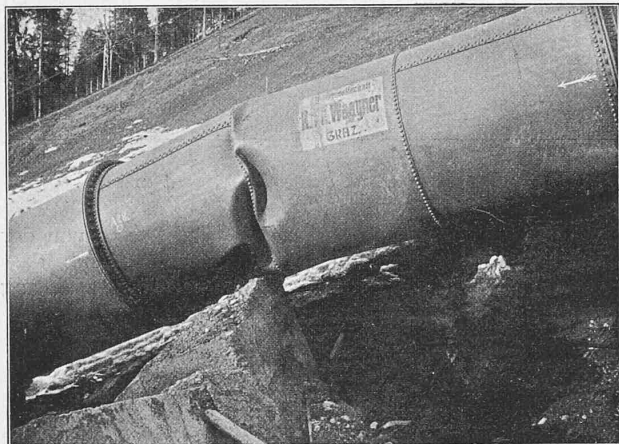
Abb. 28. Untere Knickung des Rohrstranges links.
