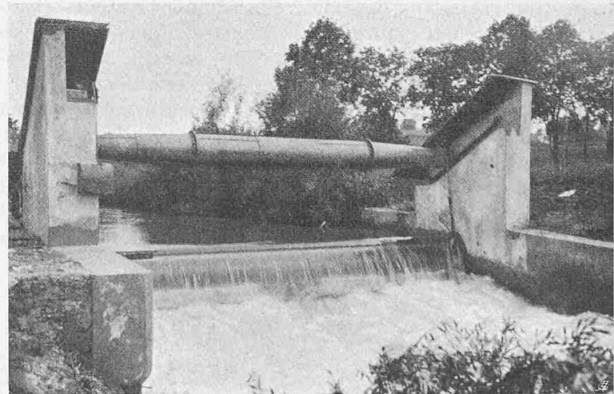
Abb. 2. Automatische Klappe in Sirmach bei Ueberflutung.
