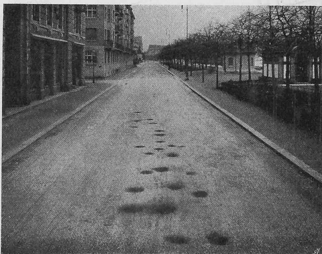
Abb. 2. Beschädigte Strassendecke aus Grauwackenschotter.
