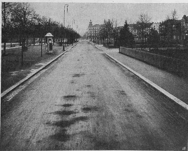
Abb. 1. Beschädigte Strassendecke aus Grauwackenschotter.
