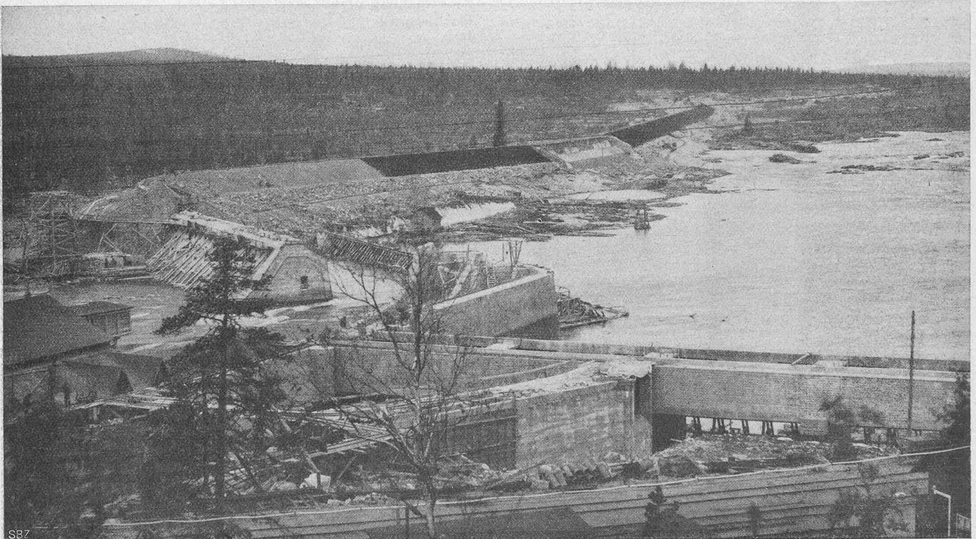
Abb. 2. Ansicht der Baustelle des Staudammes am Porjus-See, von Süden (vergl. Lageplan S. 57).
