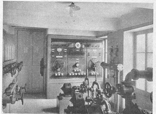
Abb. 14. Pumpen- und Reguliererraum der Zentralheizung.
