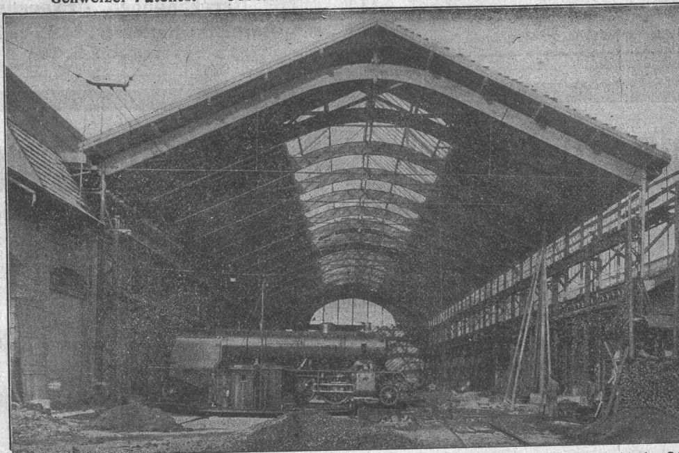
Montagehalle der Schweiz. Lokomotiv- und Maschinenfabrik Winterthur. Spannweite der Hetzerbinder 24½ m.
