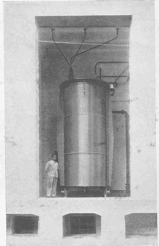
Abb. 97. Nach aussen geöffnete Transformatorzelle des Kraftwerks Amsteg.
