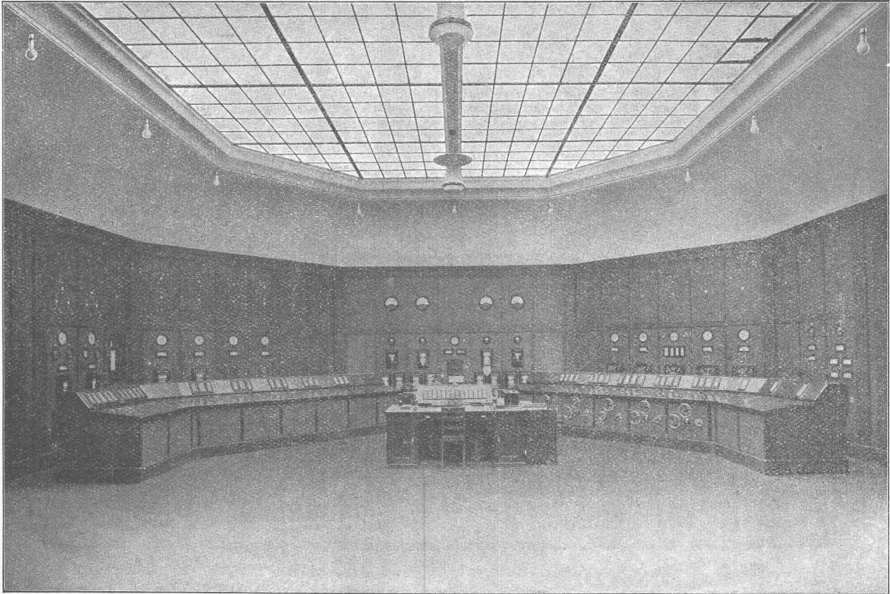
Kommandosaal im Kraftwerk Amsteg.
