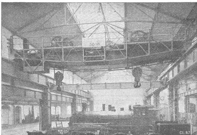
Lokomotivehebekran von 50 Tonnen Tragkraft, in den Reparaturwerkstätten der S. B. B. in Zürich.
