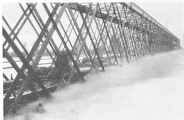
Abb. 8. Die Eisenbahnbrücke im H.-W. am Abend des 25. Sept. 1927.
