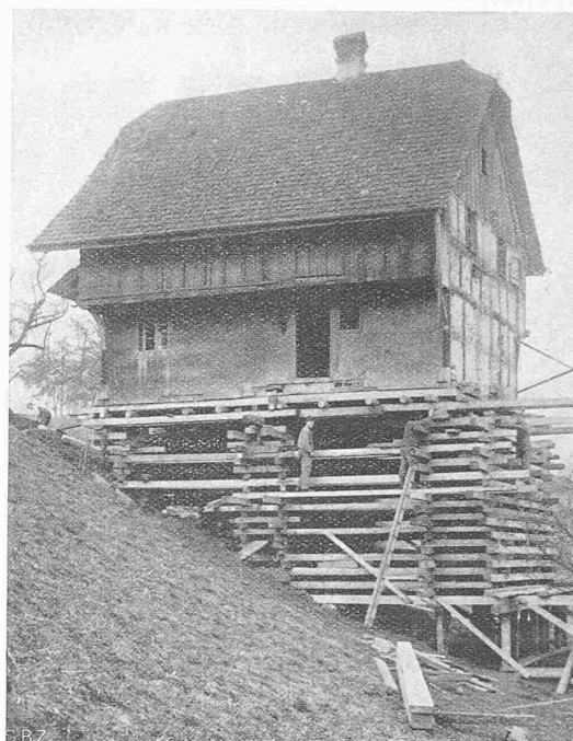
Abb. 2. Hebung auf einer 10 m hohen Böschung.
