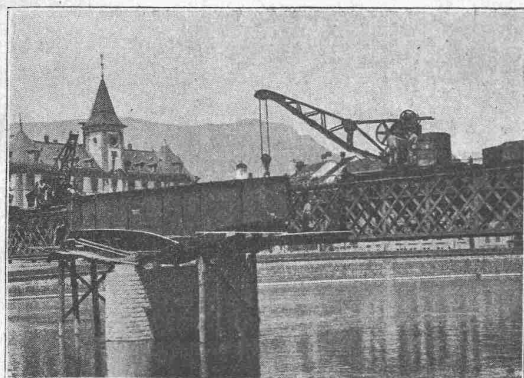
Zwei Drehkrane auf Drehstellwagen mit Wippauslegern, Tragkraft je 15 Tonnen, beim Einbau von Brückenträgern.
