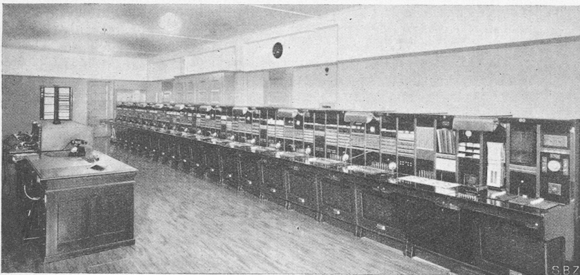
Abb. 13. Telephon-Fern-Zentrale im II. Stock.
