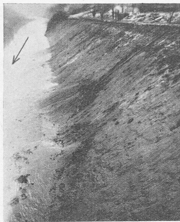
Abb. 12 Wasserseitige Dammböschung mit Zementmörtel-Austritten. (Stauspiegel abgesenkt).
